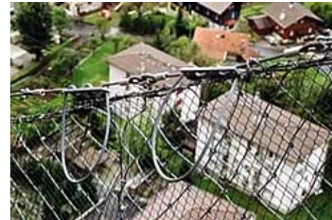
Steinschlagschutznetze oberhalb Unterseen
