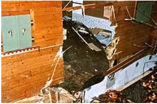
Gebäudeschaden durch Blockschlag
