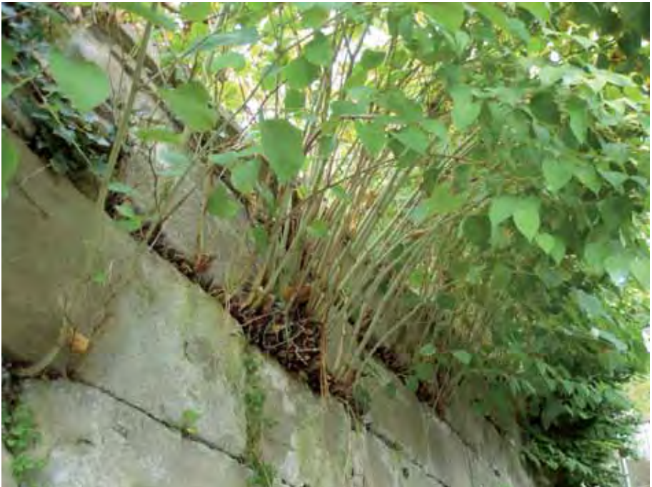
Abbildungen 27 und 28: Durch den Japanischen Staudenknöterich werden Bachufer destabilisiert und Bauten geschädigt. (Foto: E. Jörg, 2005)
